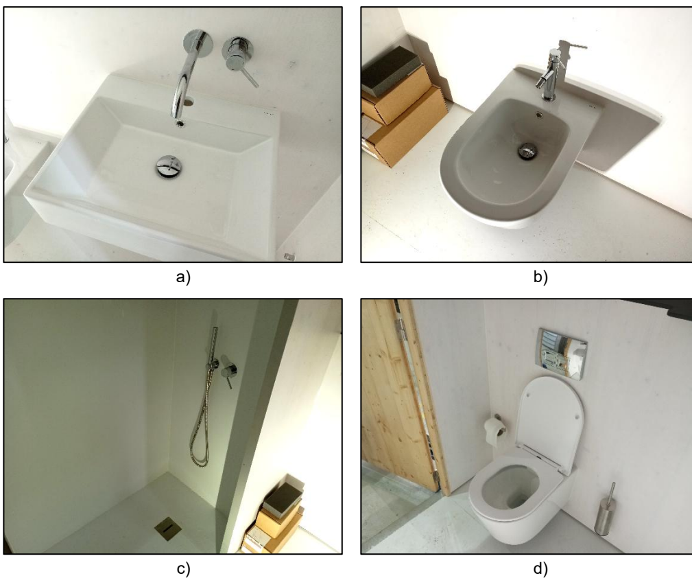
Figura 3: Dispositivos de consumo de água instalados no POD de Casa de Banho: (a) Lavatório com torneira misturadora monocomando; (b) Bidé com torneira misturadora monocomando; (c) Duche com conjunto composto por torneira misturadora monocomando e chuveiro de mão; e (d) Sanita com autoclismo interior de dupla descarga.
